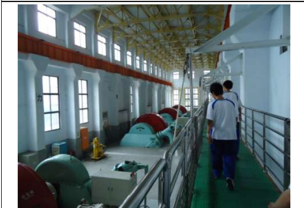
實際進入廠房參觀橫式發電機組
