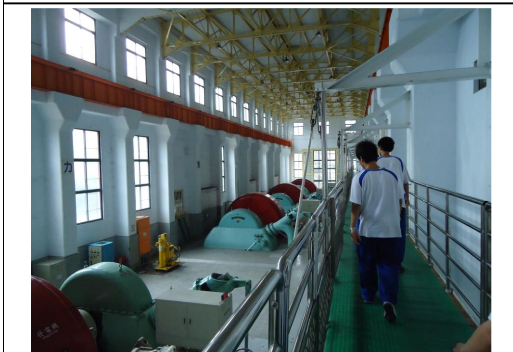
實際進入廠房參觀橫式發電機組
