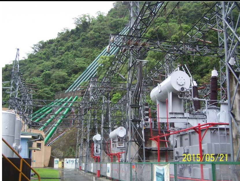
參觀發電廠外部機組
